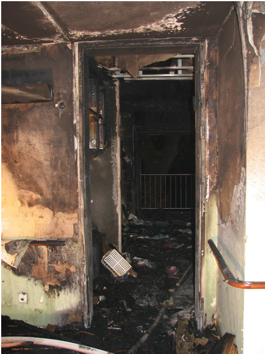
Abb. 2: Blick in den Brandraum (Brandursache Fernsehgerät) einer Senioren- und Pflegeeinrichtung
