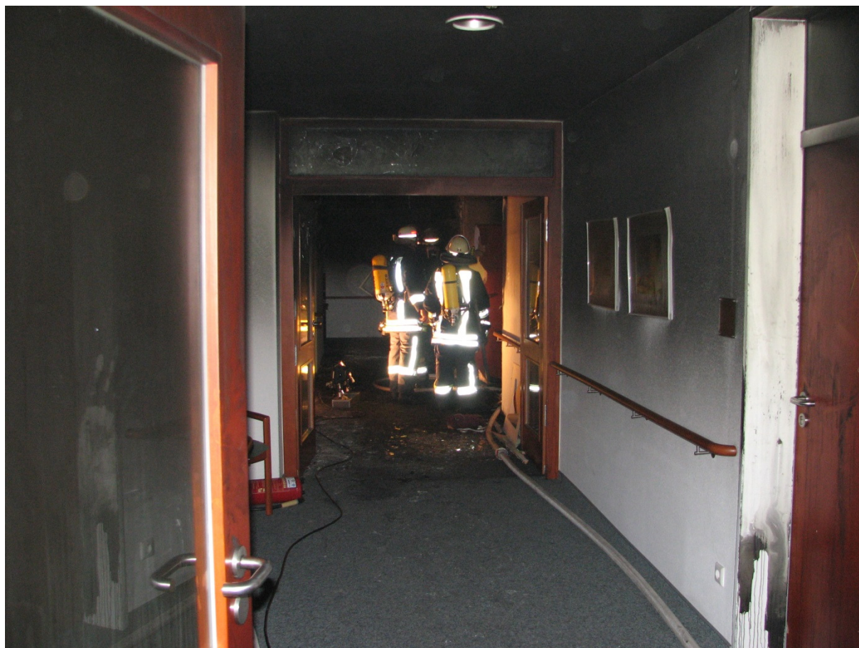
Abb. 4: Blick in den Flur mit sichtbarem Rauchschaden
