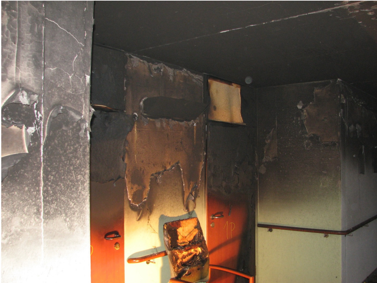
Abb. 3: Blick in den Flur, Räume neben dem Brandraum
